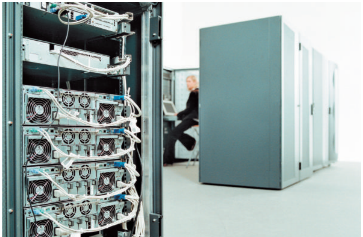
Server sind Strom- und Kostenschlucker. In Hallen mit einer Fläche so groß wie ein Fußballfeld wird in etwa so viel Strom benötigt wie in einer Kleinstadt mit 4.000 Einwohnern. Foto: Fujitsu Siemens Computers
