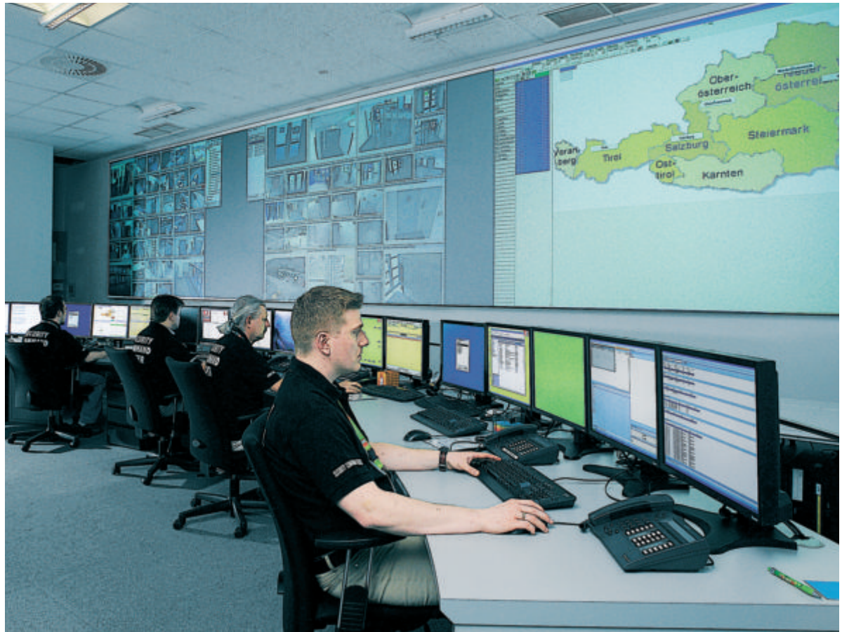
Höchste Sicherheit für die Zukunft der Kommunikation: In der Aon-Sicherheitszentrale der Telekom Austria werden die modernen Telekommunikations-Netzwerke überwacht. Foto: Telekom
