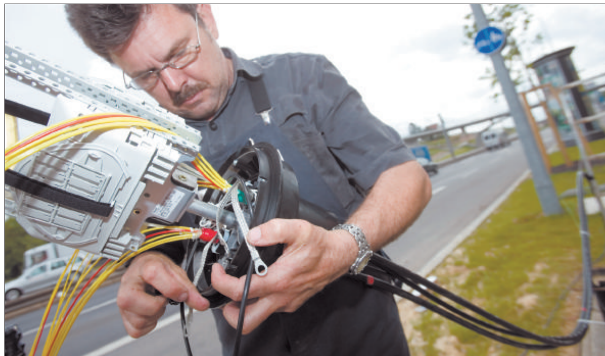
Die Dreifaltigkeit der Multimediawelt wird erst durch Glasfaser bis in die Haushalte und Büros möglich. Was in Südkorea gelebte Realität ist, muss bei uns erst unter die Erde. Foto: Deutsche Telekom
