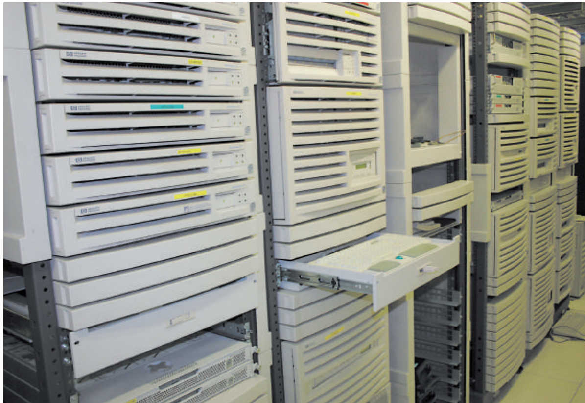
Ökologisch und ökonomisch: Strom sparende Technologien und energieeffiziente Virtualisierungslösungen helfen, auch große Rechenzentren wirtschaftlich zu betreiben. Foto: Raiffeisen Informatik
