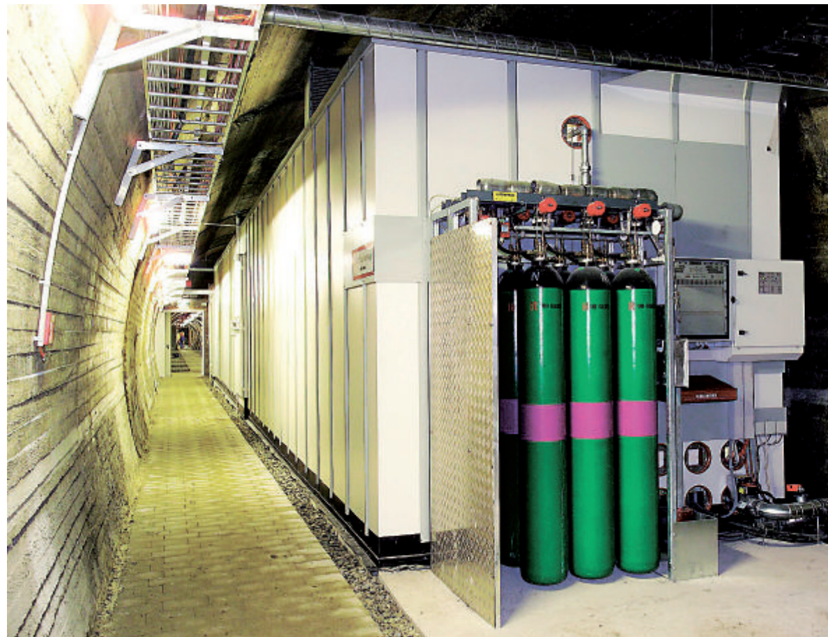
Die technische Infrastruktur des Earth-Data-Safes befindet sich in einem Stollensystem, das 320 Meter in den Berg reicht und bis zu 150 Meter hoch mit Gestein überdeckt ist. Foto: Kapsch
