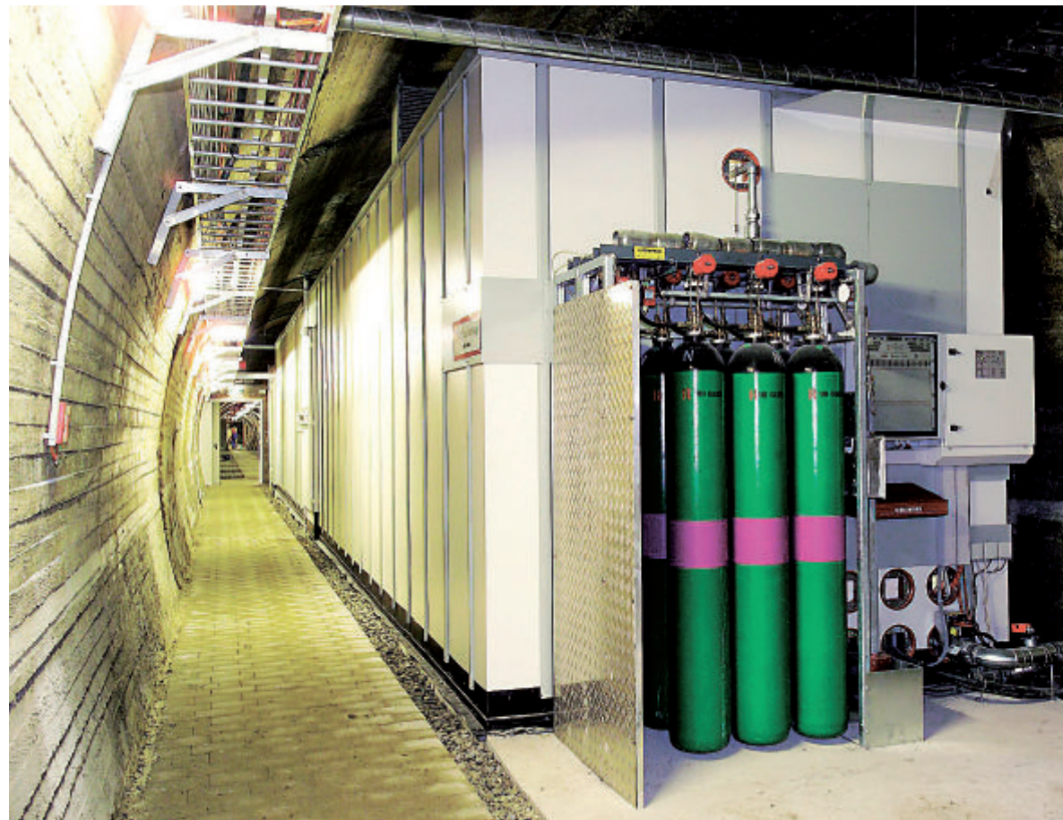
Die technische Infrastruktur des Earth-Data-Safes befindet sich in einem Stollensystem, das 320 Meter in den Berg reicht und bis zu 150 Meter hoch mit Gestein überdeckt ist. Foto: Kapsch
