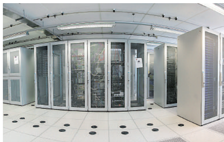
Nicht nur die Server selbst, auch die Räume, in denen diese untergebracht sind, müssen geschützt werden. Foto: Fotolia.com
