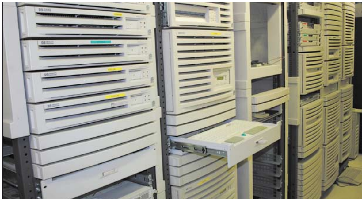
Die Zusammenarbeit mit einem professionellen Rechenzentrum ermöglicht Unternehmen Zugang zu technischer Expertise, Prozessverbesserung und neuesten Technologien. Foto: Raiffeisen Informatik
