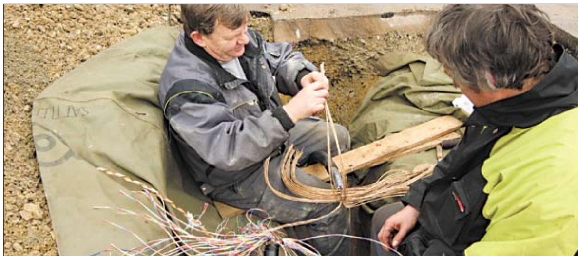
Kupfer zählt zum alten Eisen. Glasfaser wird benötigt, um auch in Zukunft dem steigenden Datenverkehr entgegenzutreten zu können. Foto: Telekom Austria
